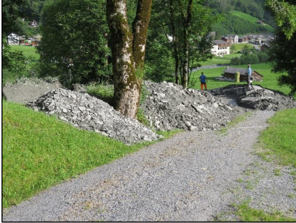
Bild 1: Durch Murgangereignis beschädigte Güterstrasse.
