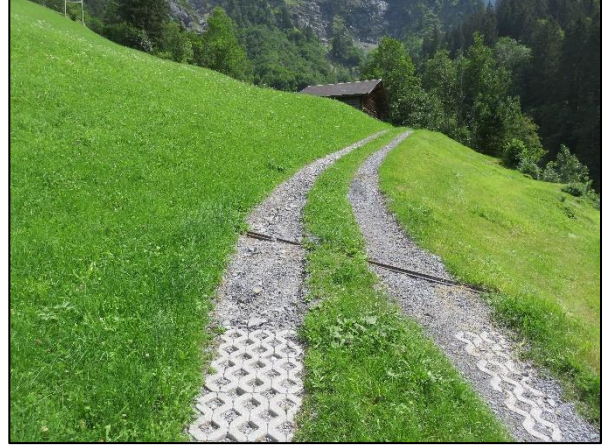
Bild 2: Ausgewaschene Güterstrasse, die mit Ecorastern verstärkt werden soll.
