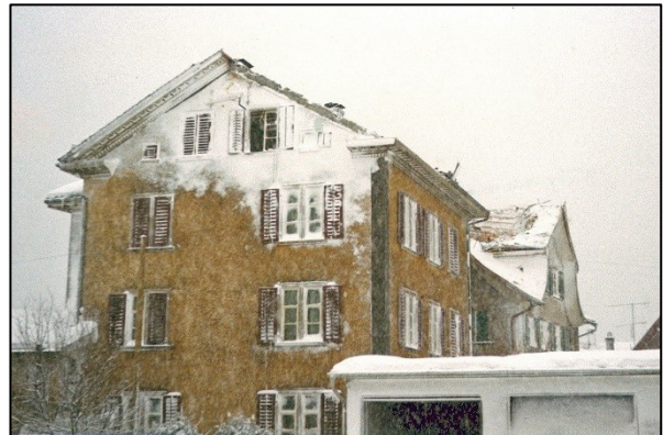
Bild 2: Gebäudeschaden nach Staublawinen-niedergang (Foto: Hans Speck, Netstal)
